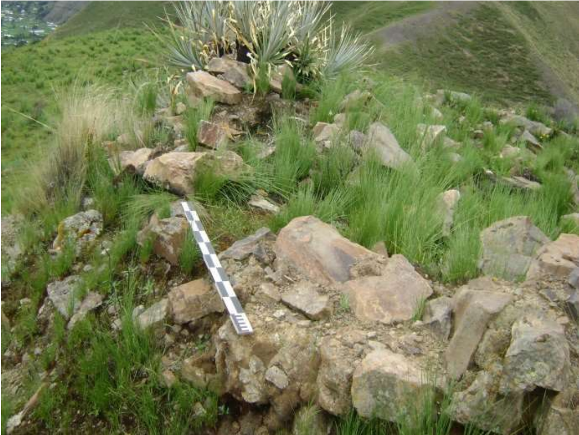
FOTO 17: E.C. 6. El estado en que se encuentra el muro es muy malo.
