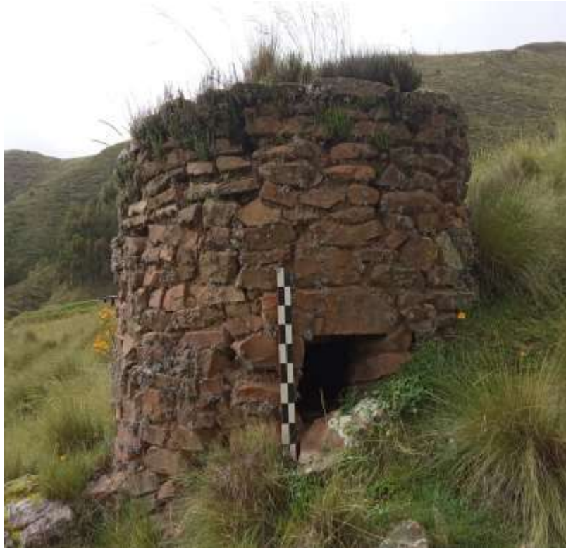
FOTO 27: E.C.1. La estructura se mantiene en regular estado de conservación como se puede observar.
