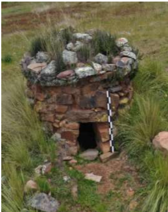
FOTO 29: E.C. 2. La estructura se mantiene en regular estado, la vegetación, el agente nocivo que perjudica sus paramentos.
