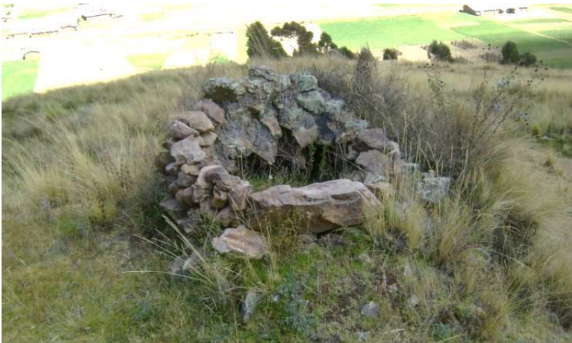
FOTO3: E.C. 2. Se observa el estado en qué encuentra la estructura.
