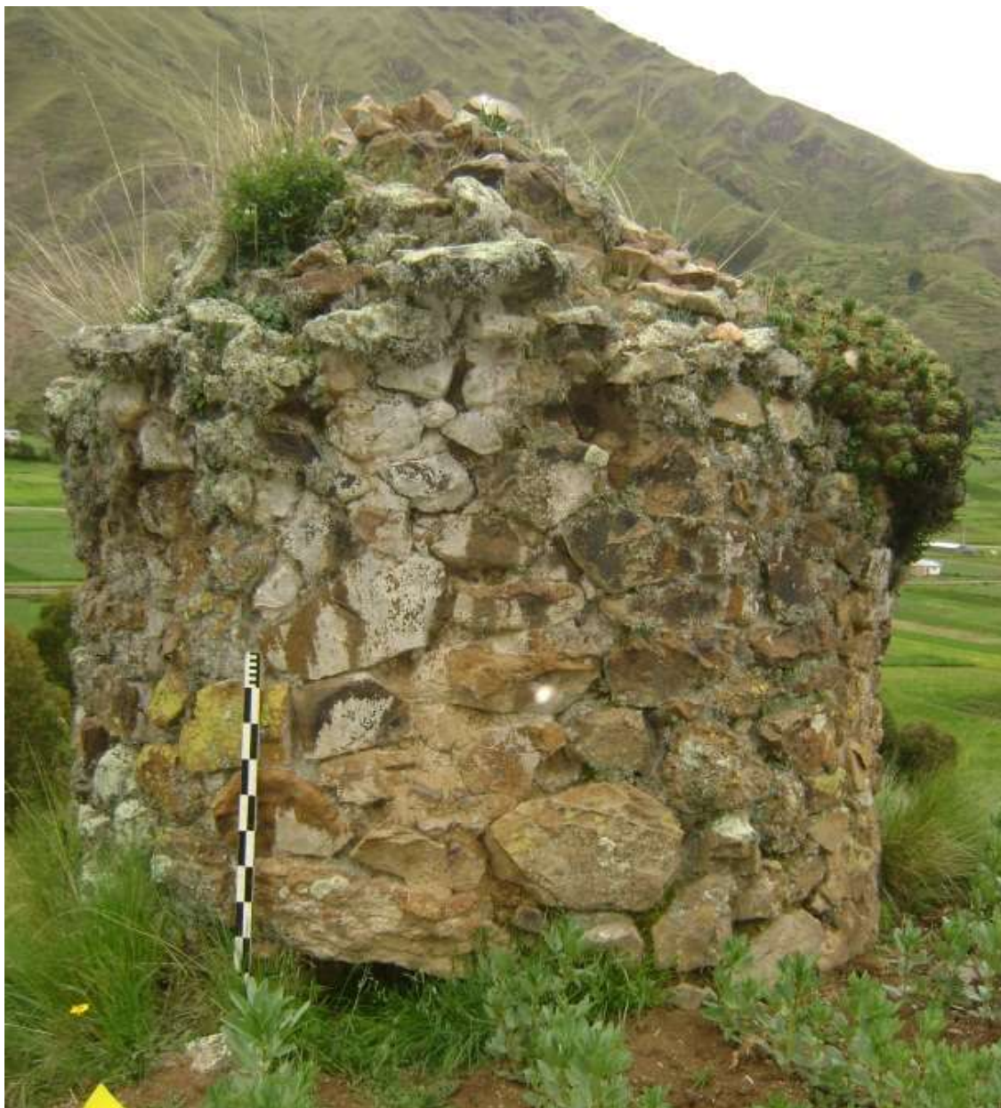
FOTO 9: E.C. 5. Se observa que la estructura ha sufrido deterioro a causa de la vegetación
