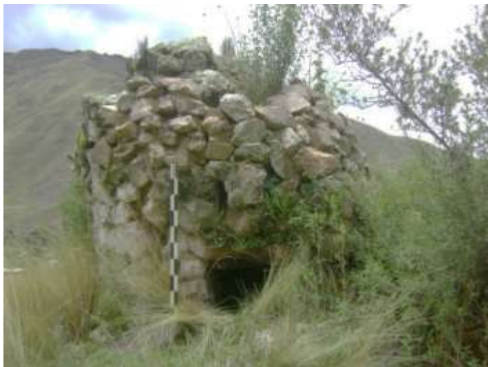
FOTO 4: E.C. 3. Se observa de como la vegetación es factor importante en la destrucción de estructura haciendo que este colapse.
