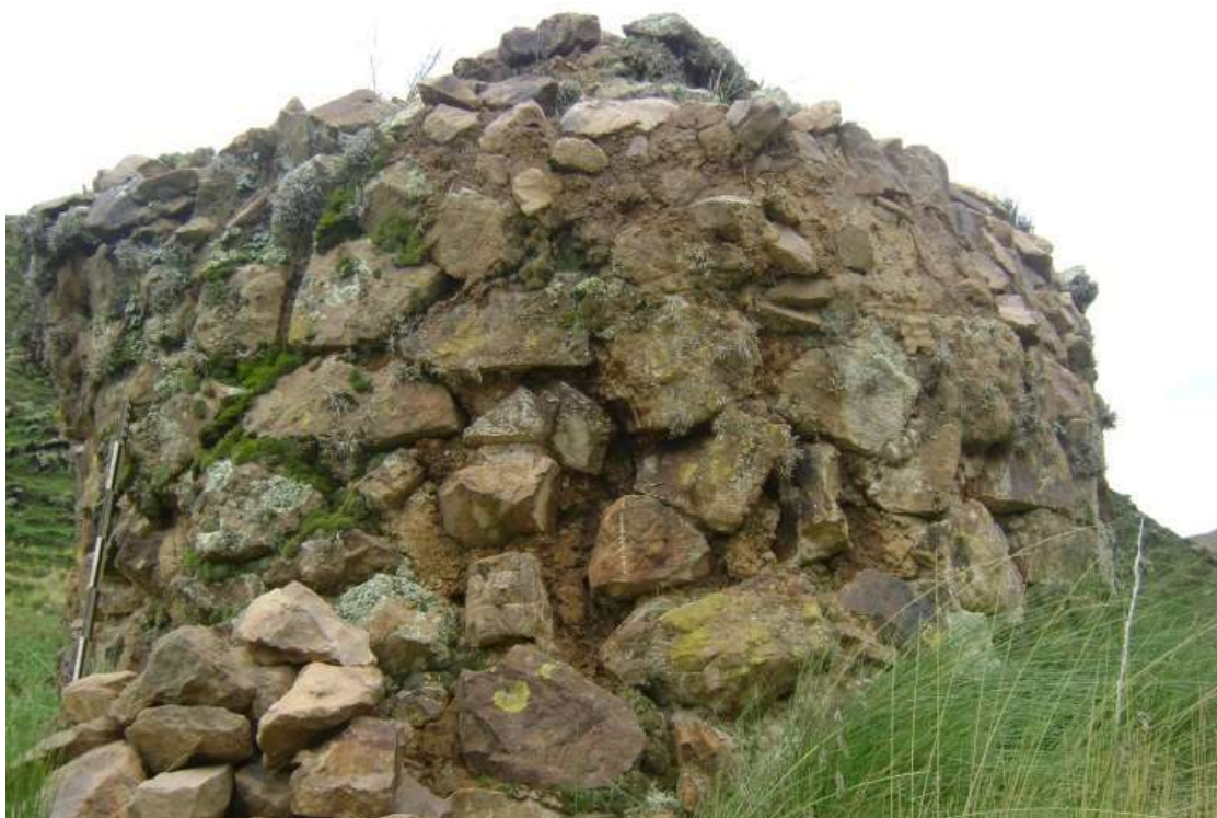
FOTO 8: E.C. 5. la parte posterior de la estructura, se encuentra en proceso de colapso y se observa los trabajos de mantenimiento preventivo por parte de la población.
