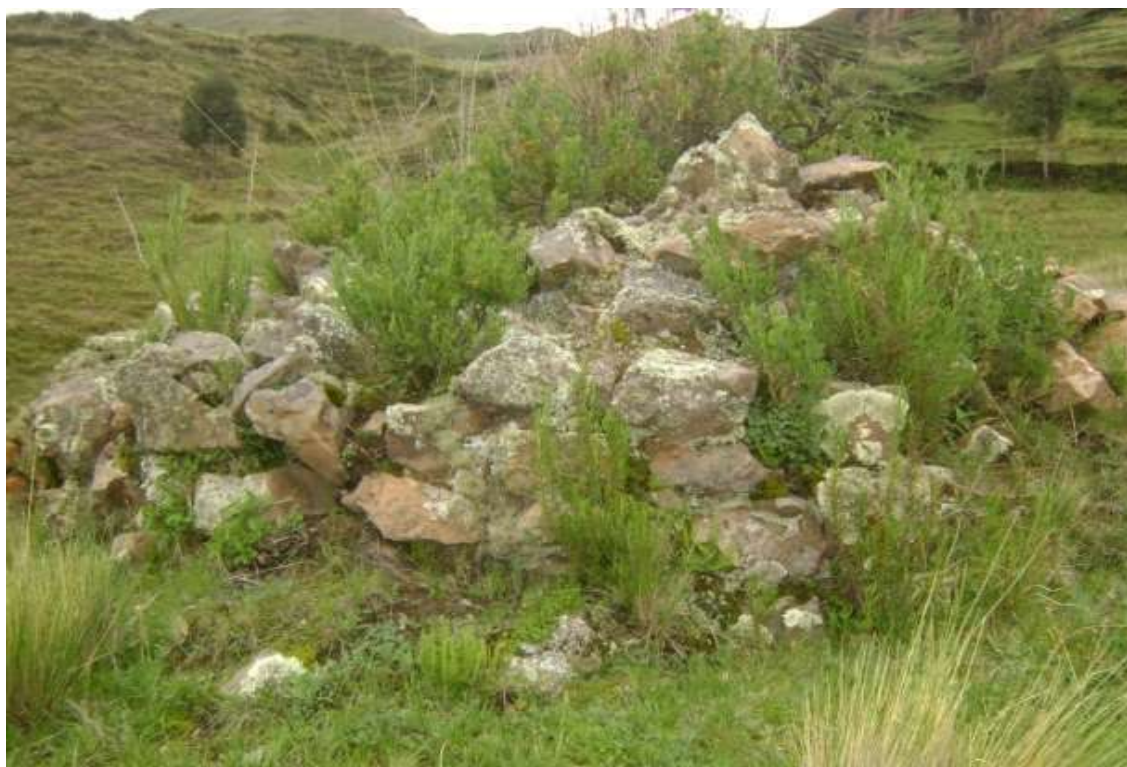
FOTO 6: E.C. 4. La estructura colapso y sus elementos se hallan soterrados en su interior.
