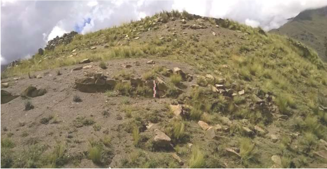
FOTO 25: M.P. 2. Se observa el real estado en que se encuentra el muro perimétrico.
