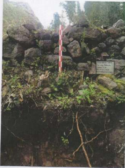
Foto N° 9, Vista del muro de contención del andén N° 26. Paisaje Arqueológico de Kullkunchayoq -Distrito de Calca, departamento de Cusco.
