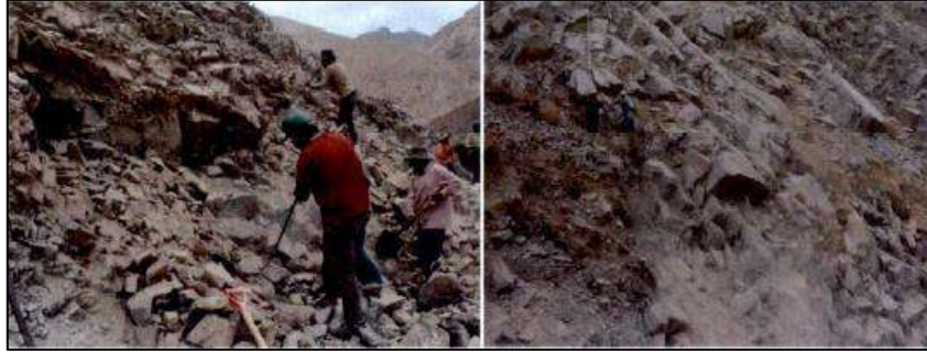
FIGURA 277: Ejemplo de Desquinche de taludes
