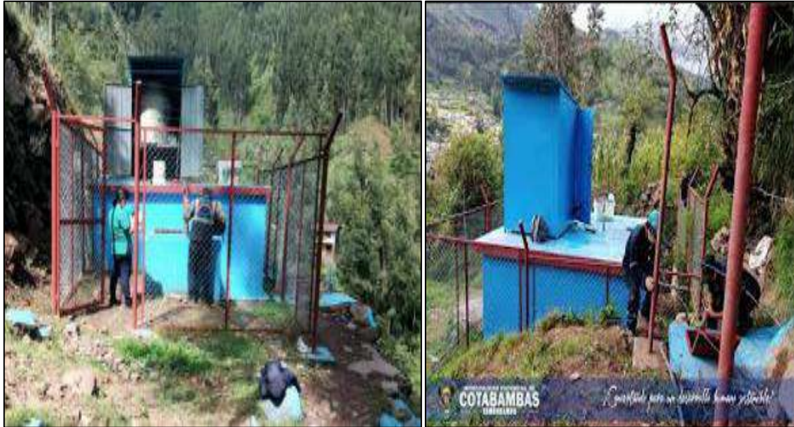
FIGURA 13: Reservorios de agua que abastecen a la ciudad de Tambobamba
