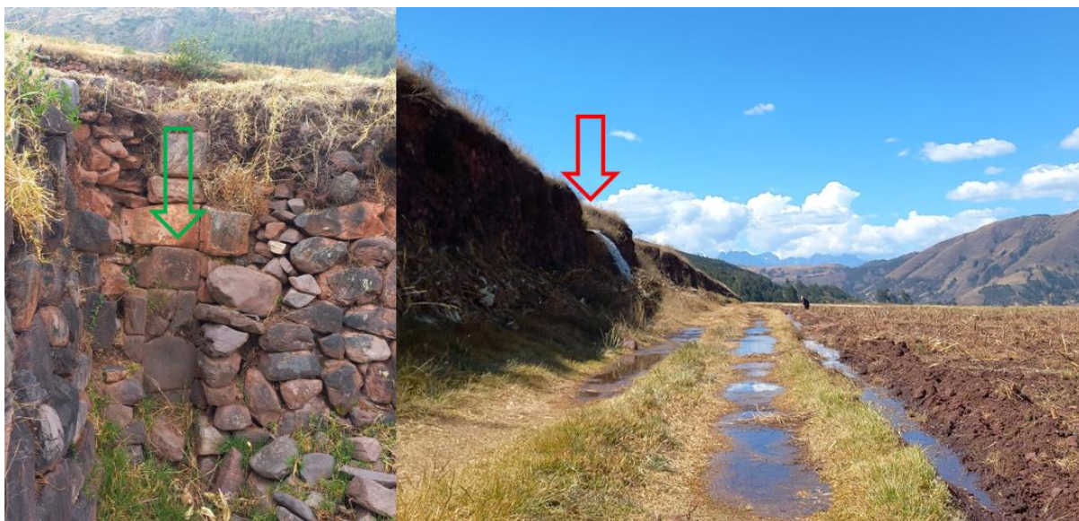
Figura 16 Proceso de destrucción del andén por riego moderno
