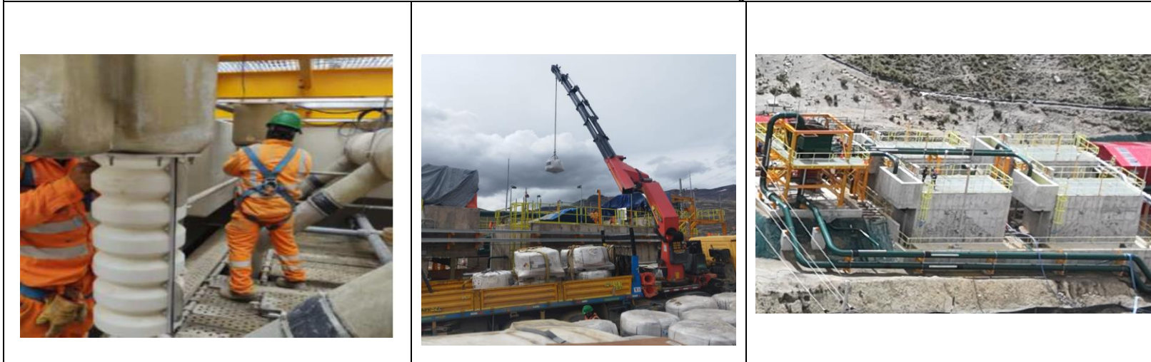
Instalación de manifold , arena y vista de distribución de Cajones de Filtro
