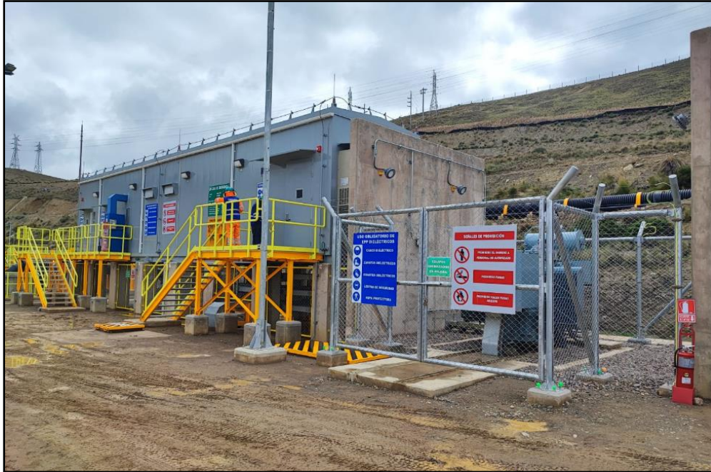
Sala Eléctrica 6250-ER-001 y Transformador 6250-TF-001
