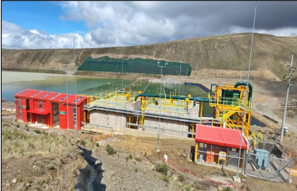
Figura 35 Estructura de Cajón de alimentación a filtros y Distribución de Cajón de Filtro
